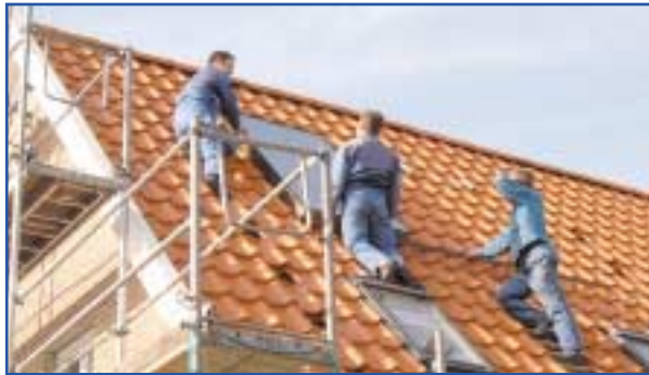
Thermische Solaranlagen – ein Beitrag zum Klimaschutz!
